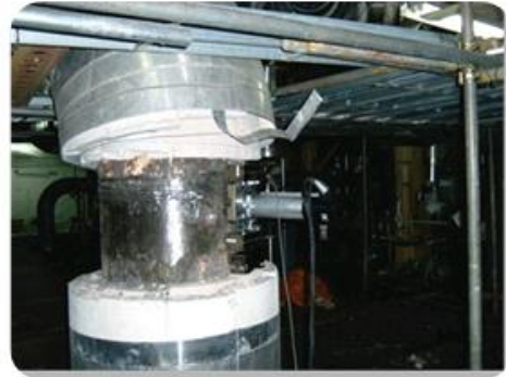
보령 화력 발전소 (Hot reheater Line)
